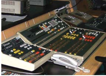
7 부조정실 스위처 Console(공사 전)
