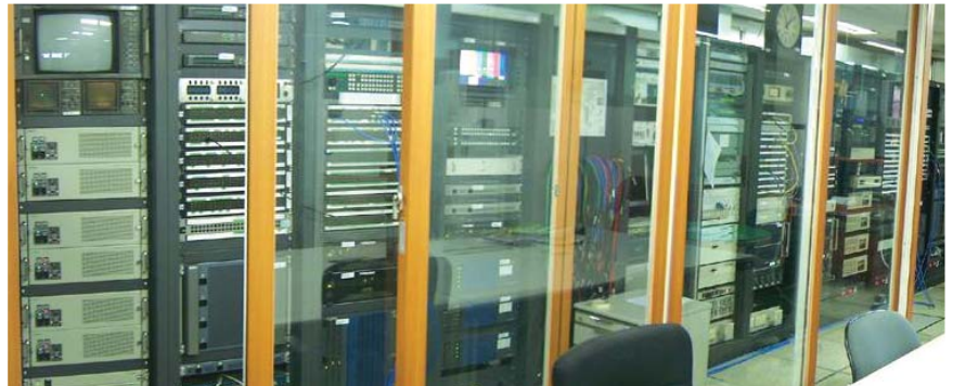
11 TOC 장비실 RACK [1, 2부조운영 장비실]
