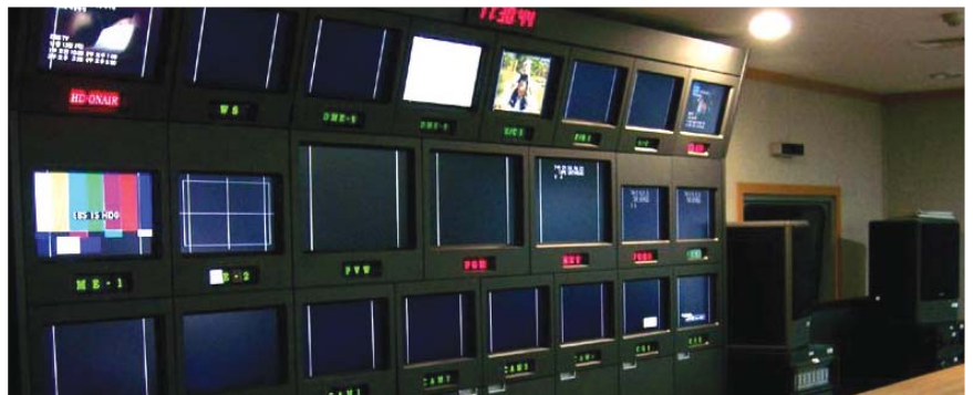
12 2부조정실 월모니터(공사 후)
