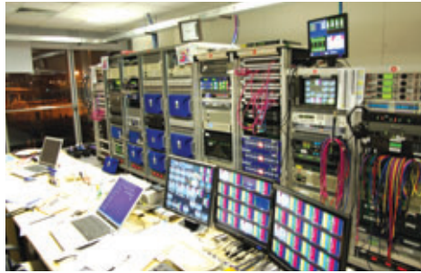
장비실 - 장비 Rack 10개 설치, 화선조정센터
