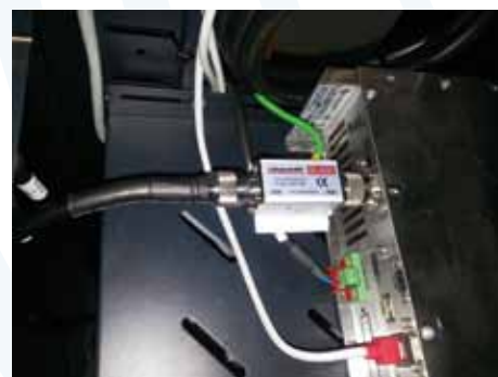
그림 9. 송신기에 설치된 RF용 서지보호기
