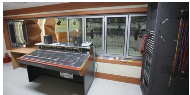
그림 15. 공개홀 2층에 설치된 PA실
