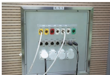
그림 14. 스튜디오 Wall Box
