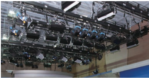
그림 7. 뉴스스튜디오에 설치된 LED 조명들
