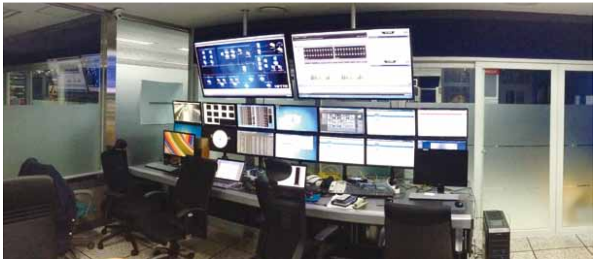
NPS 관제실 및 기계실
