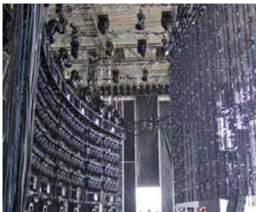
[그림 3] 천정과 벽에 설치된 조명기기. 조명 하나하나에 번호가 있으며 장면에 따라 각각의 위치와 색이 바뀐다.
