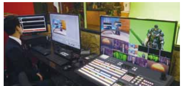
Control Room에 설치된 Ross Video의 제작 장비들
