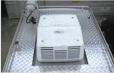
그림 6. Roof platform의 CCTV, 에어컨
