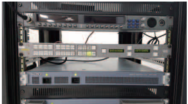
TV부조에 설치된 통합라우터 리모트
