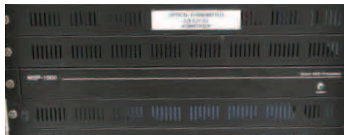
강원도 평창 동계올림픽 선수촌에 설치된 신호처리기
