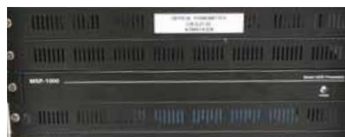
강원도 평창 동계올림픽 선수촌에 설치된 신호처리기
