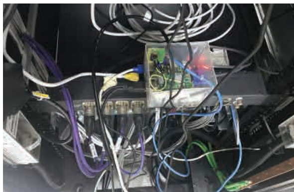
라디오 주조 Rack에 설치 모습
