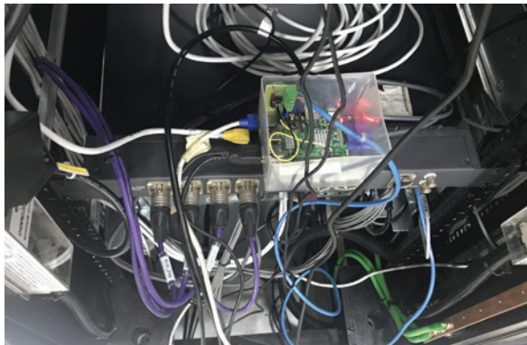
라디오 주조 Rack에 설치 모습
