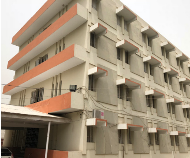
물탄 PBC 건물 모습, 보이는 면 뒤쪽이 허물어져서 건물의 절반만 사용 중이었다
