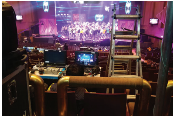
그림 9. Aerial Production System 컨트롤러 설치 모습
