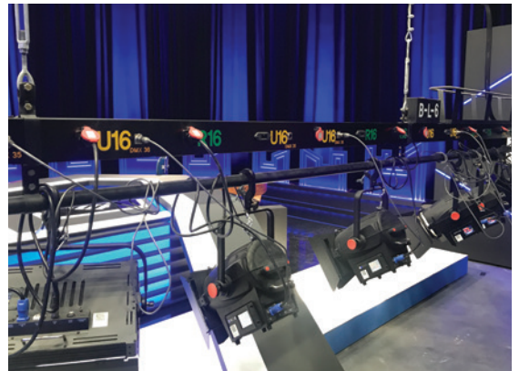
kbc 제작 스튜디오 - 버튼 전원시설 RD, UPS 각각 1회로 220V 타입과 C-타입, DMX는 총 2회로 1회로당 4개
