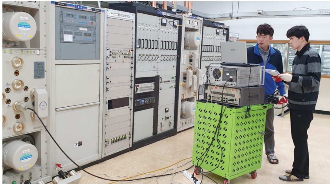
무선국 수검 사전 측정
