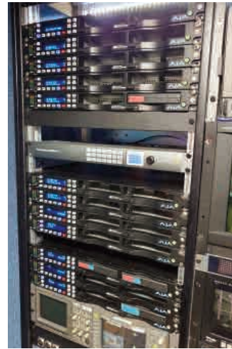
중계차에 설치된 KIPRO
