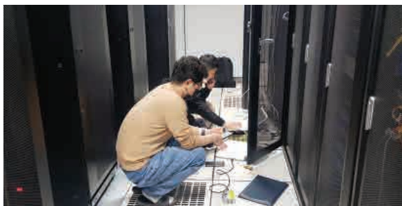
IPTV 인코더 설치 현장
