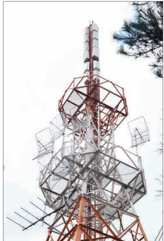
적응형 배열 안테나 기술이 적용된 수륜TVR의 송신탑. 6개의 파라볼라 안테나와 아래쪽의 6-Array 야기안테나(타겟 신호를 최대로 수신하며 간섭 신호를 최소로 수신한다)로 UHD 신호를 수신한다.
