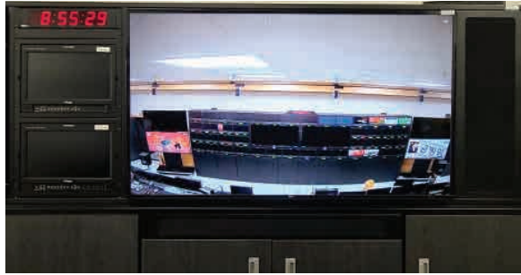
그림 25. CCTV 녹화 화면
