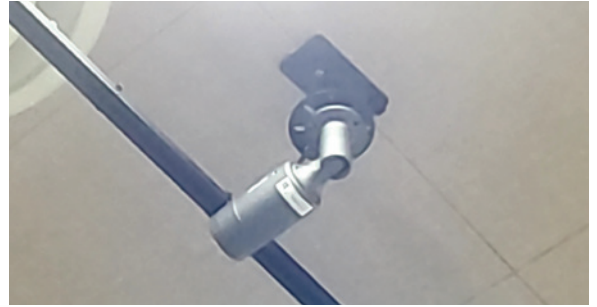
그림 26. CCTV 설치 모습
