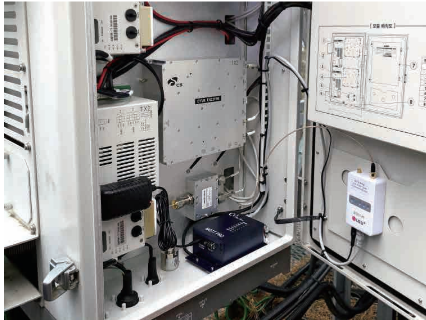
그림 8. 옥외형 중계기 내부 설치
