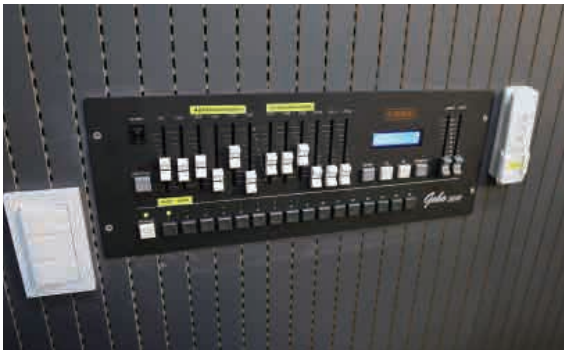
벽 한쪽의 조명 컨트롤러
