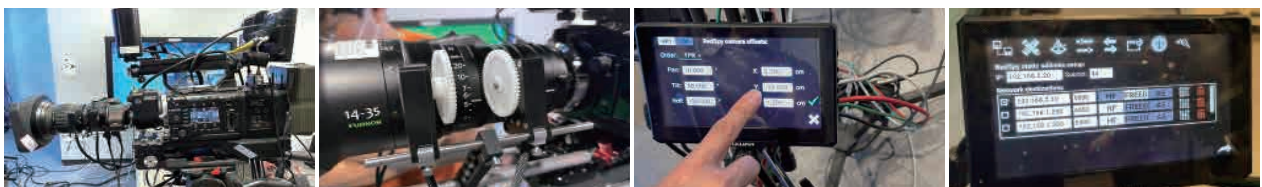
카메라 트래킹 장치 보정, 전송 IP 셋업, 기어 구성, 설치된 모습
