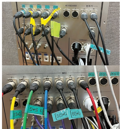
그림 11. A부스 안의 각종 마이크와 장비 연결(Wall BOX)
