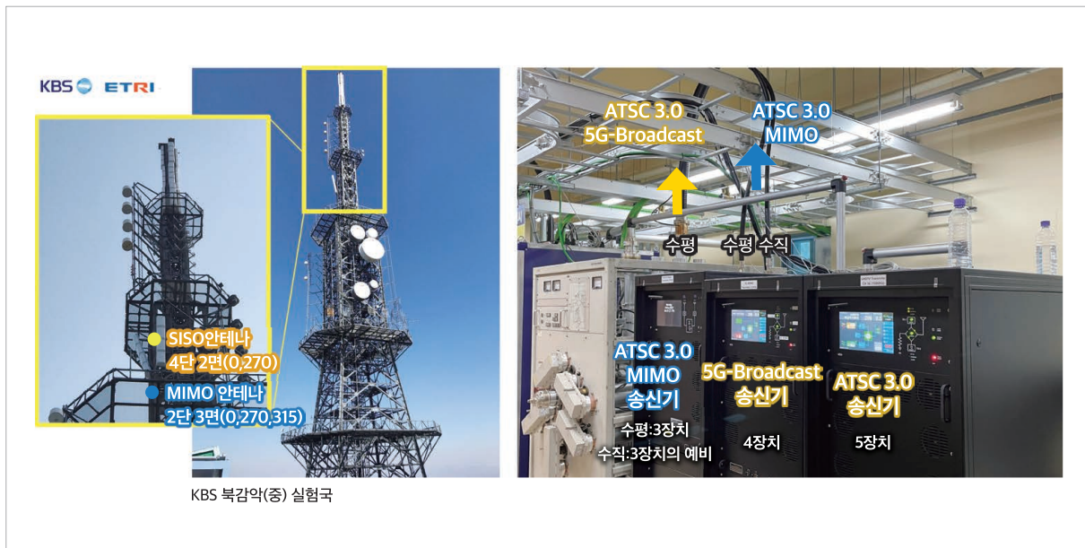
그림 6. KBS 북감악 실험국, 우리나라 무선국 허가를 정식으로 득한 장치들이다 (좌) 송신 철탑에 설치된 4단 2면 SISO 안테나 및 2단 3면 MIMO 안테나, (우) 중계소 3층 기계실에 설치된 실험용 송신기
