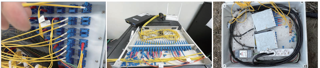
그림 3. 통제동 통신실 광회선센터 FDF(Fiber Distribution Frame, 광분배함) 및 발사대 사면 광 합체
