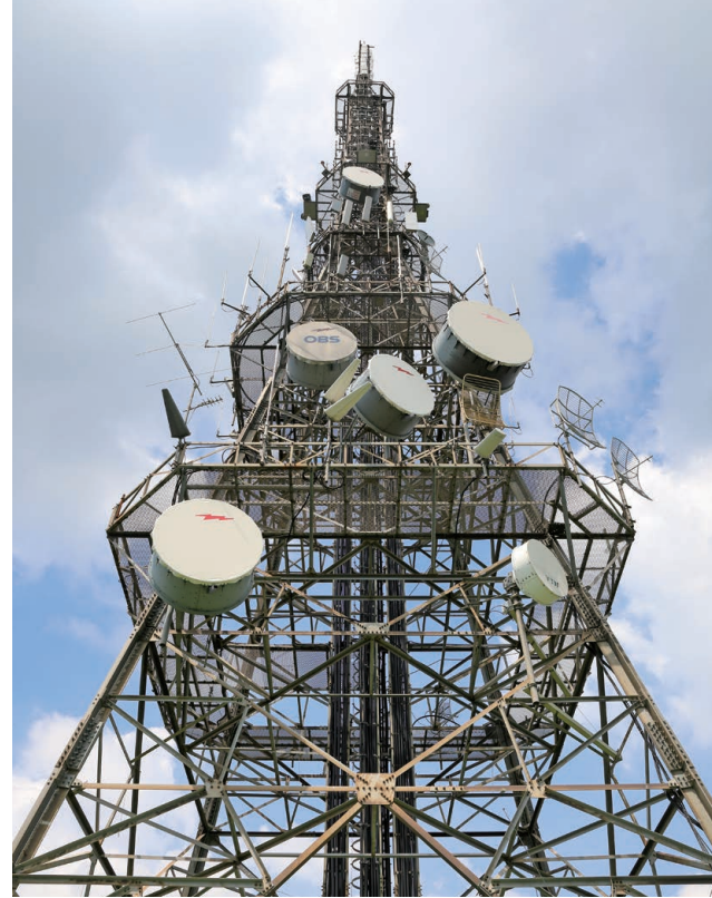
계양산중계소의 안테나 철탑, 연주소의 신호를 수신 후 증폭하여 경인지역으로 송출한다
