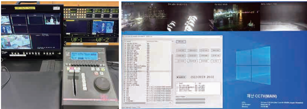
그림 23. LSM 장비와 재난 CCTV 서버
