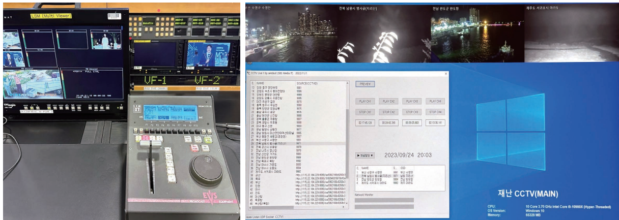
그림 23. LSM 장비와 재난 CCTV 서버
