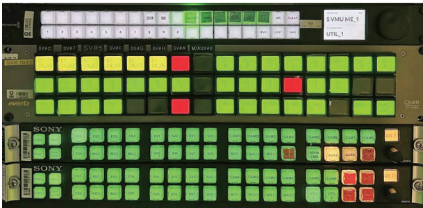
그림 17. 컨트롤러 입력 선택용 라우터 및 스위치 AUX 패널
