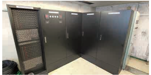
그림 16. 조광실 내 DMX Patch rack & RD rack
