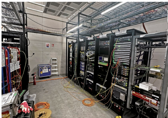
그림 9. 장비가 설치된 CTA
