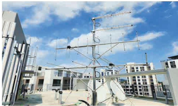
그림 4. 건축 옥상 안테나 수신설비 설치 사례
