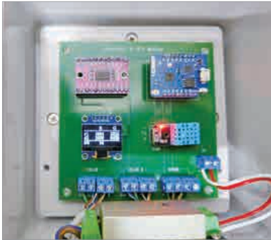
그림 5. 전원 시설 감시 장치
