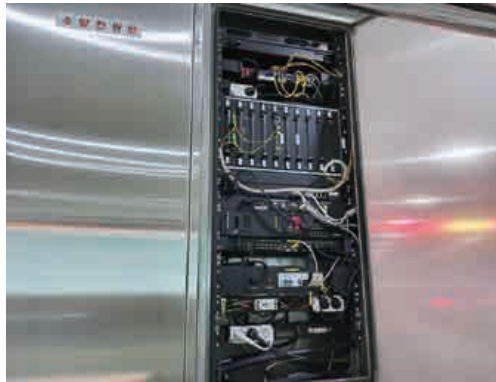
터널 무선중계시스템 내부 설비
