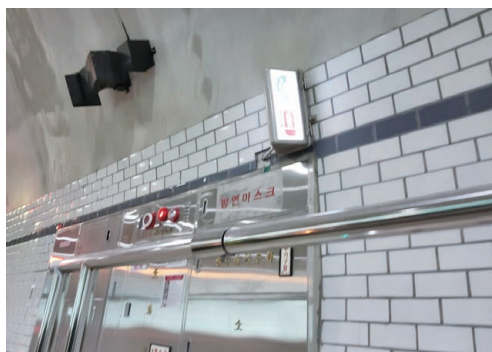
터널 내 비상방송 스피커 및 장비 설치를 위한 함체와 긴급전화 표시등 사진
