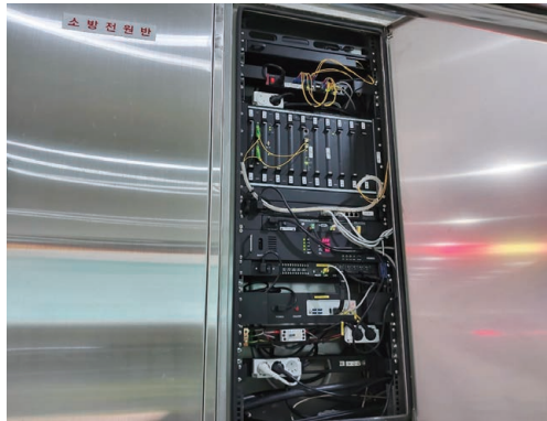
터널 무선중계시스템 내부 설비
