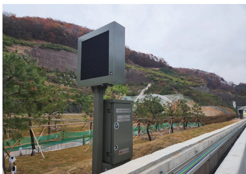
터널 진입 안내 장치 (안전운행 표지등)
