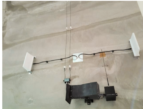
터널 내 중계안테나 및 비상방송 스피커, 데이터 수집장치
